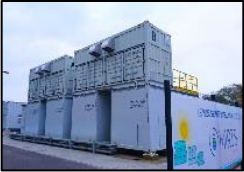
John Cockerille 1.7MWh C&I
