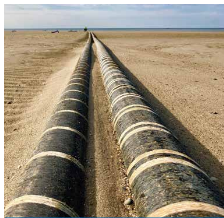
イギリス-ベルギー間海底ケーブル
