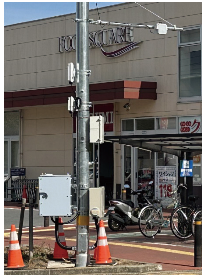
写真1 公道実証実験時の設置状況
