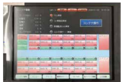
統合BMU (Battery Management Unit) モニタ表示 車載電池を「群」として再利用した蓄電システムを監視・管理する
