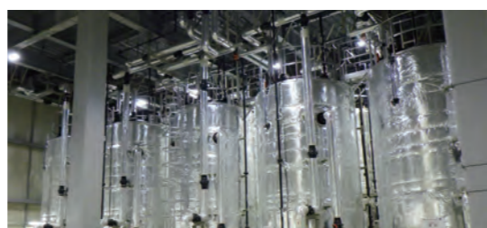
1F:タンク、ポンプ、交直変換装置 Floor 1: Tank, Pump and PCS
