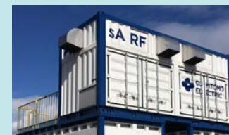
レドックスフロー電池
