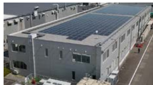
住友電工プリントサーキット(株)の太陽光発電設備
