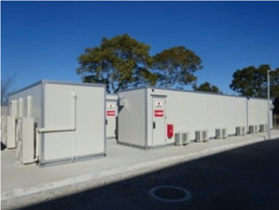
写真2 蓄電池システム
