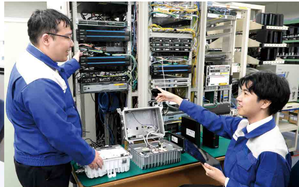
CATVシステム部・機器検査風景
