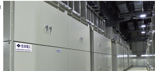
2F:セルスタック、熱交換器 Floor 2: Cell stack and heat exchanger
