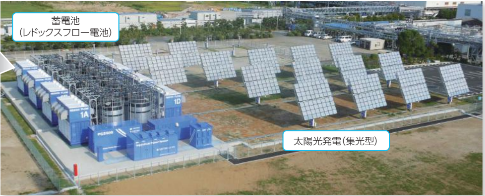
住友電工 横浜製作所での使用例
