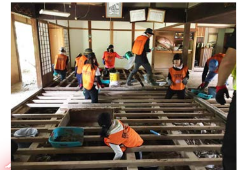
17 台風被害があった京都府綾部市の災害復旧活動(室内外の清掃・泥だし・家具移動・片付けなど)
