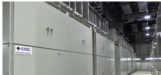
2F:セルスタック、熱交換器 Floor 2: Cell stack and heat exchanger
