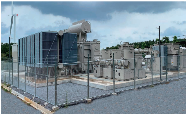
グリーンパワー深浦風力発電所に設置した変電所設備
