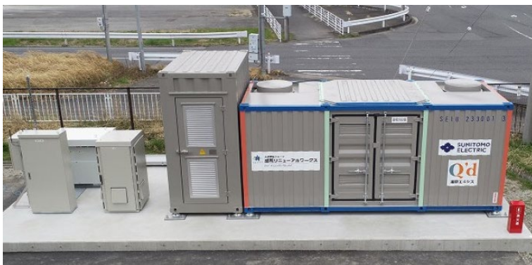
納入したレドックスフロー電池
