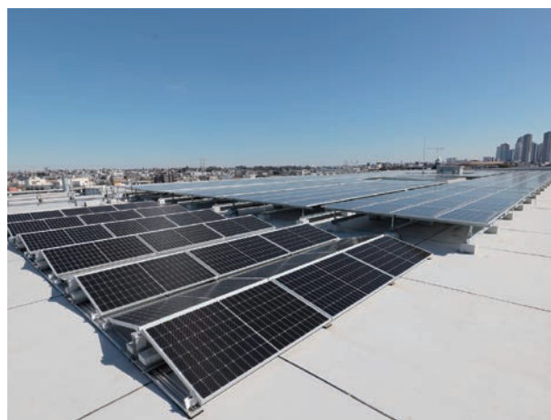
研修施設「住友電設 川崎テクニカルセンター（2023年3月開所）」屋上に設置した太陽光発電設備
