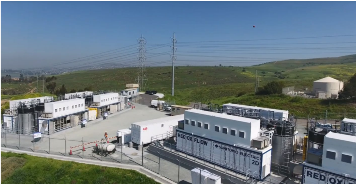
図 カリフォルニア州に設置した RF 電池設備
