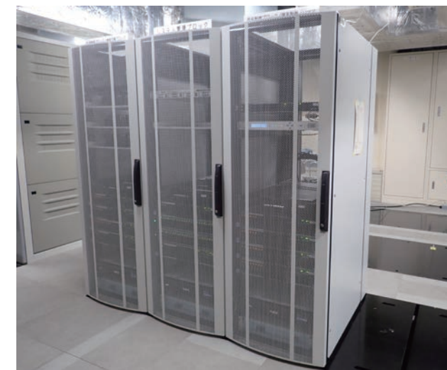
広島県警交通管制上位システム
