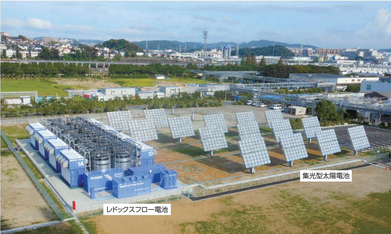
大規模蓄発電システム実証プロジェクト(横浜製作所)
