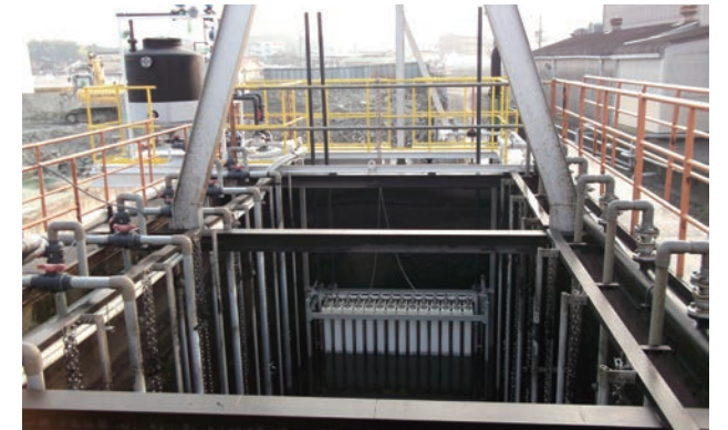
大阪製作所東食堂水処理装置
