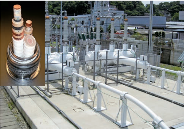
超電導ケーブルプロジェクト
