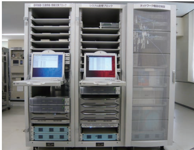
鳥取県警交通管制システム
