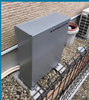
▲狭小スペース設置例
