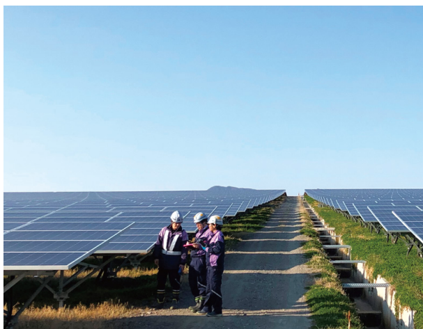
メガソーラーの施工のようす
