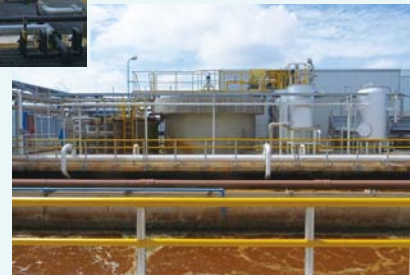
タイ工場の排水処理装置
