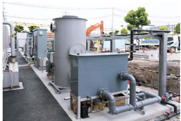
当社大阪製作所で稼動する排水処理装置
