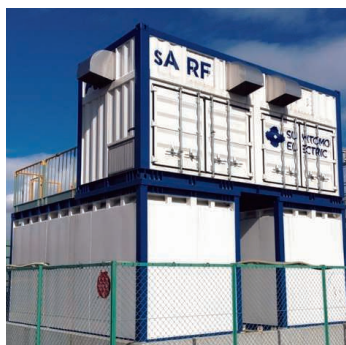
レドックスフロー電池
