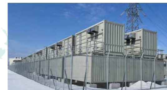
为北海道电网株式会社提供的全钒液流電池系统
