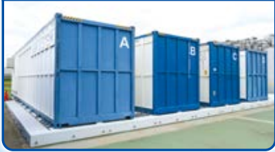
全钒液流电池
