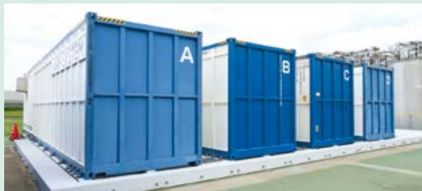
箱型全钒液流电池
