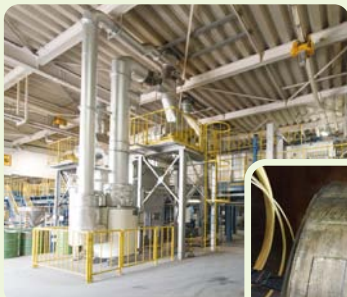
回收淬火炉的废热产生蒸汽
